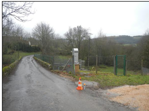
DO 1 amont STEP (extérieur)
