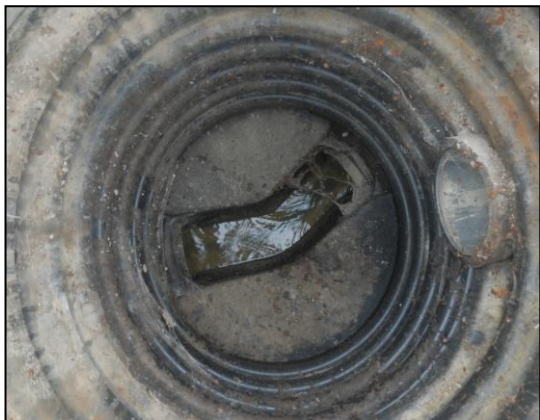
DO 1 amont STEP (intérieur)
