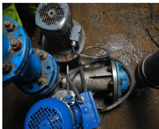
2 pompes en ligne
